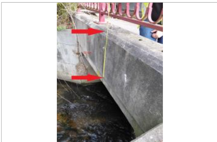
Laisse de crue à - 50 cm/haut du soubassement du pont.
