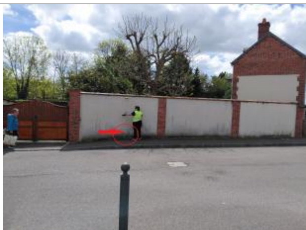
Laisse de crue à 30 cm/sol du trottoir.
