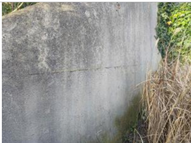
laisse d'inondation sur muret au lavoir de Montbizot
