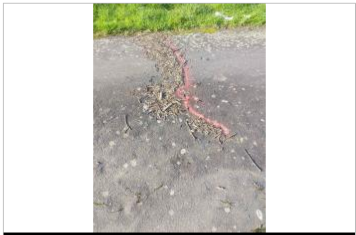
laisse d'inondation, marquée à la peinture
