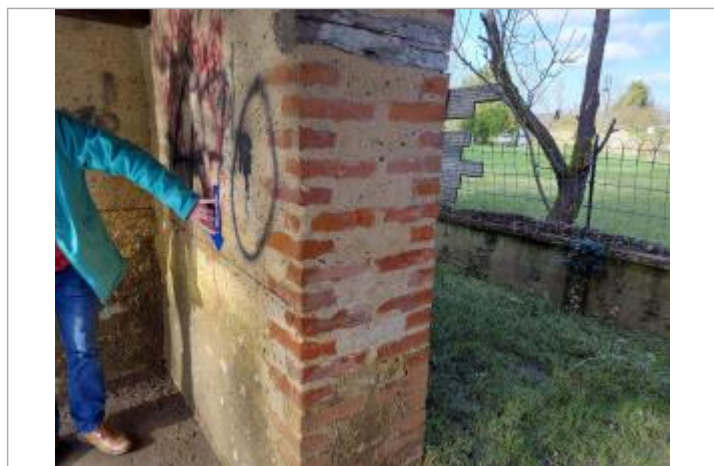
laisse d'inondation, mesurée à 0,87 m au-dessus du sol du lavoir
