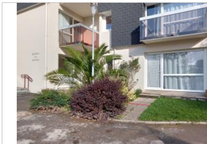
Laisse de crue résidence les Peupliers
