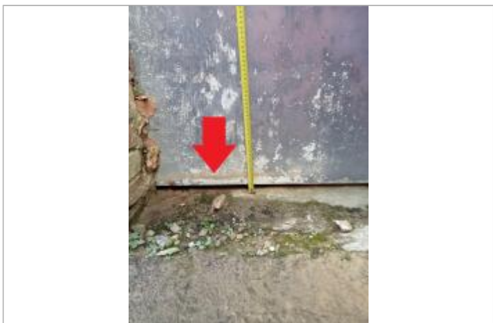
Laisse de crue de 6 cm en bas de porte bleue
