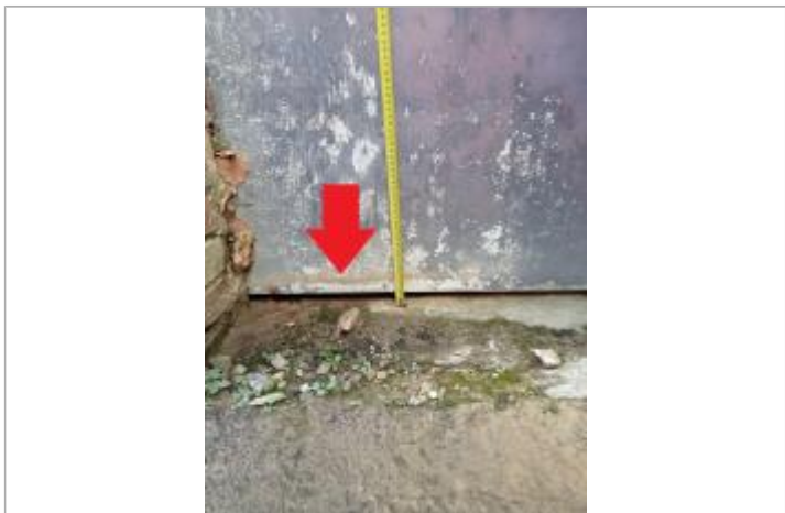
Laisse de crue de 6 cm en bas de porte bleue
