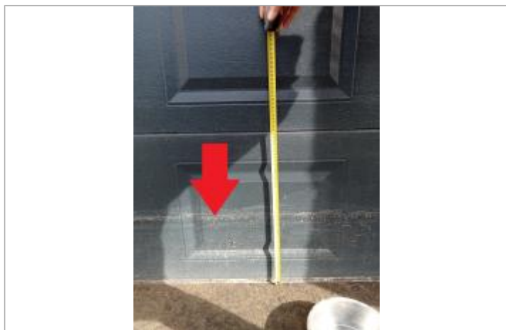
Laisse de crue de 25 cm sur porte du garage au n°9 bis
