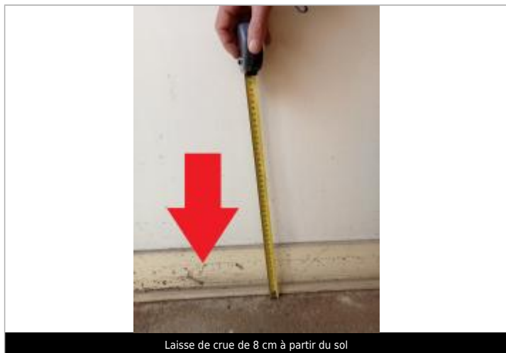
Laisse de crue de 8 cm à partir du sol
