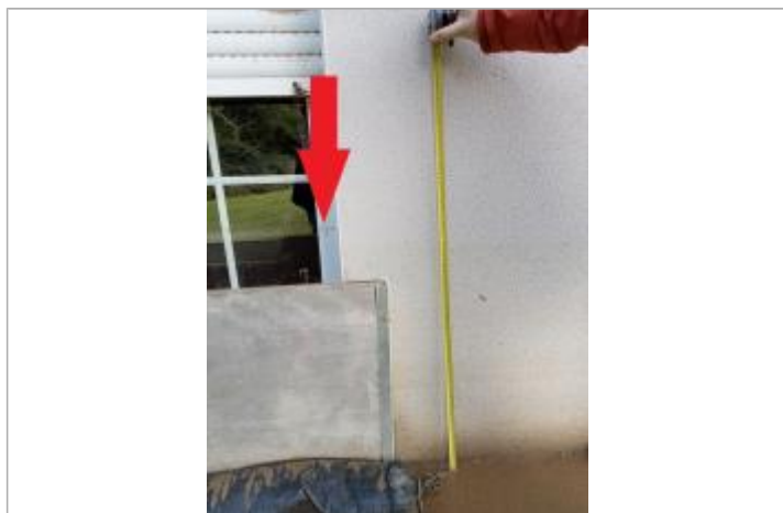
Laisse de crue à 70 cm par rapport à la dalle en béton
