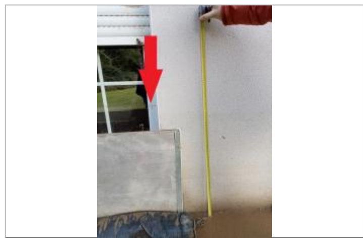
Laisse de crue à 70 cm par rapport à la dalle en béton
