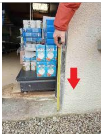
Laisse de crue de 20 cm sur le côté droit du garage
