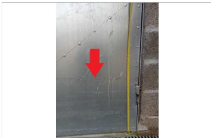
Laisse de crue de 43 cm sur porte de garage
