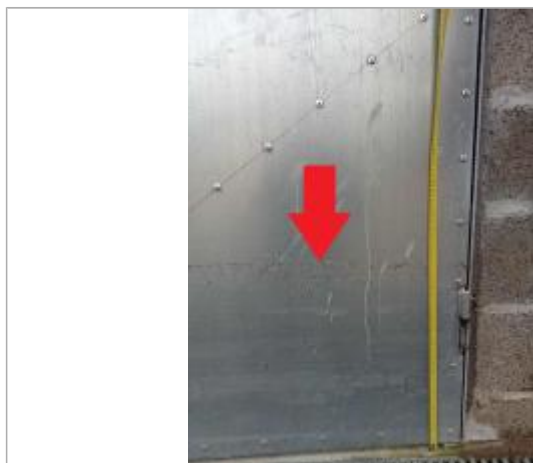
Laisse de crue de 43 cm sur porte de garage
