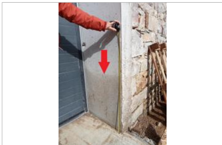
Laisse de crue à 65 cm par rapport à la dalle du garage
