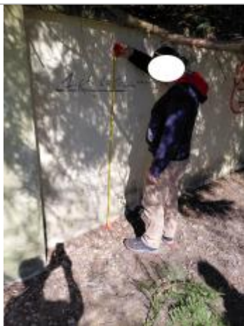
Laisse de crue à 139 cm/sol.
