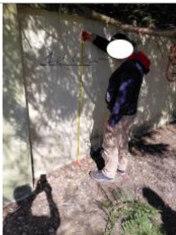
Laisse de crue à 60 cm/sol.
