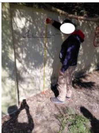
Laisse de crue à 135 cm/sol.
