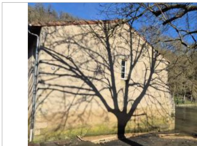
Repères STBE04-R (en haut) et STBE03-R implantés à l'arrière de la mairie
