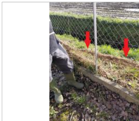
Laisse de crue à 40 cm/haut du muret sous le grillage de la clôture.
