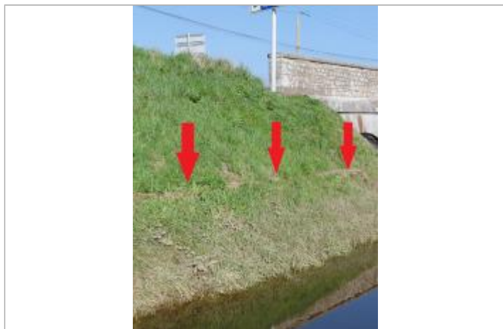
Laisse de crue au sol.
