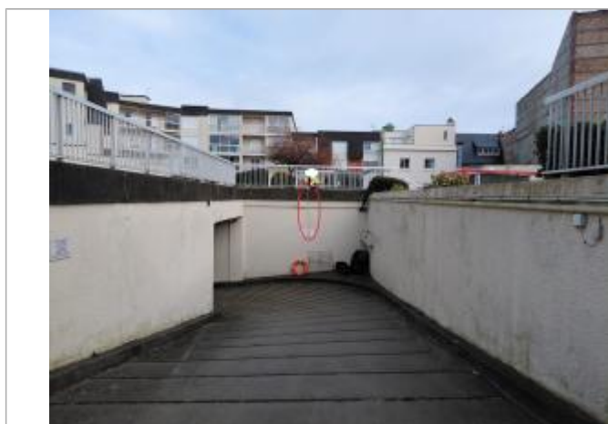
Laisse de mer à 208 cm/haut du mur.
