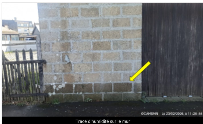
Trace d'humidité sur le mur
