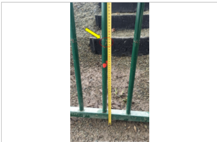
Dépôt de sédiments/végétation sur les barreaux de la porte. Mesure prise sur le barreau du milieu.
