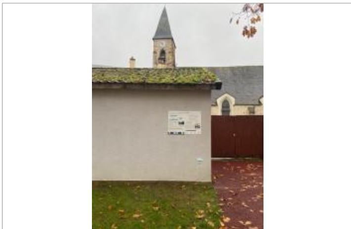
Repère de crue du 31 mai 2016 de l'Yvette à Saint Rémy lès Chevreuse
