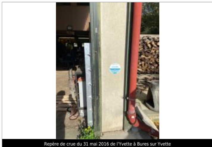
Repère de crue du 31 mai 2016 de l'Yvette à Bures sur Yvette
