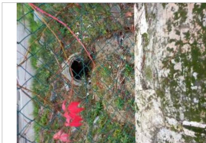
Vue rapprochée de la laisse de crue, auteur : DDT 42, prise de vue du 31/10/2024
