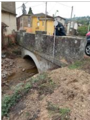
Vue rapprochée de la laisse de crue, auteur : DDT 42, prise de vue du 31/10/2024
