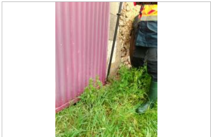
Vue sur la laisse d'inondation
