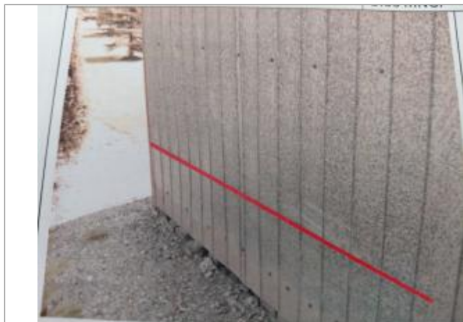
Laisse de crue à 75 cm/sol.
