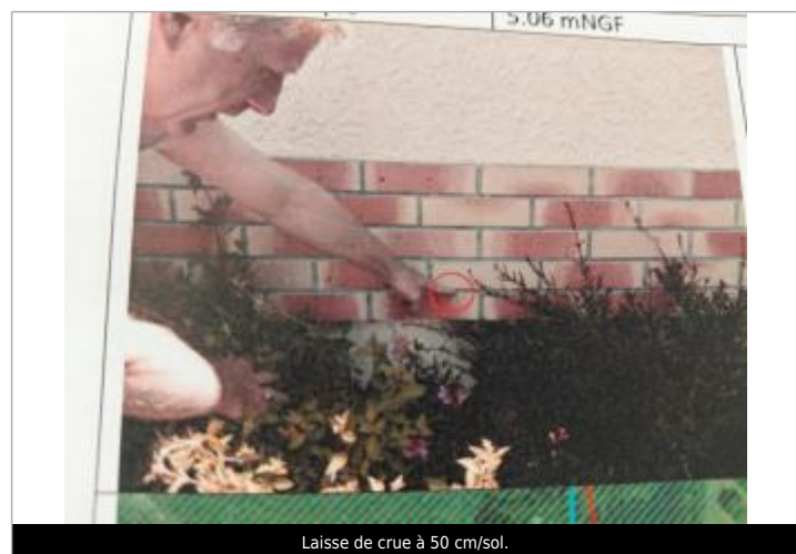
Laisse de crue à 50 cm/sol.
