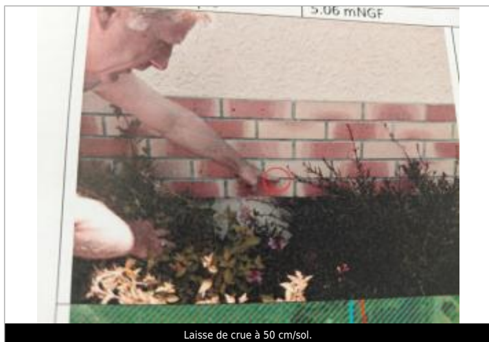
Laisse de crue à 50 cm/sol.
