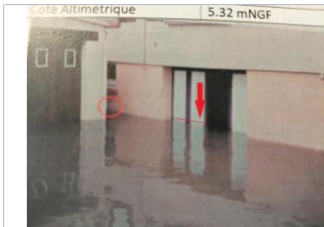
Laisse de crue à 70 cm/sol.
