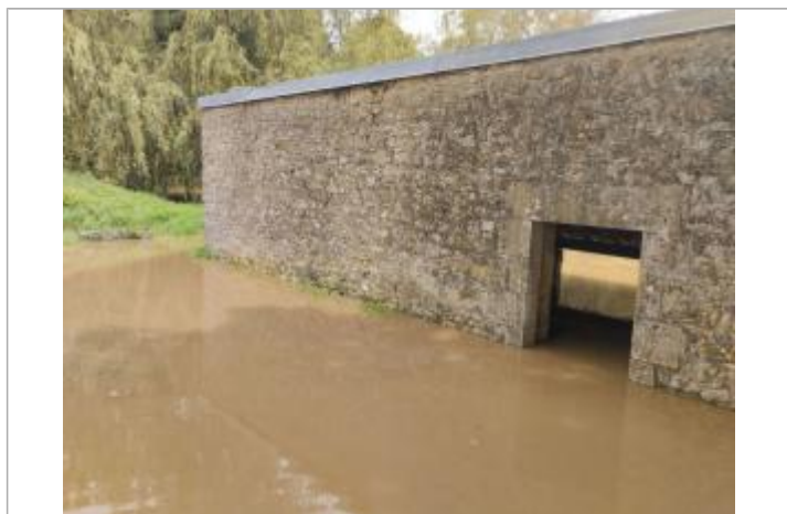
Vue du repère lors de la crue
