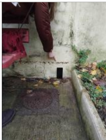
Marque d'inondation sous le banc public, devant le bâtiment de la Police Municipale
