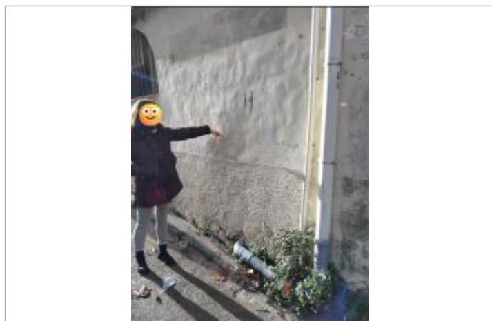
Marque d'inondation sur le mur au n°2 de la rue Léon Penchinat
