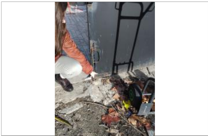
Marque d'inondation sur le bas du portail du n°37 place de la Libération
