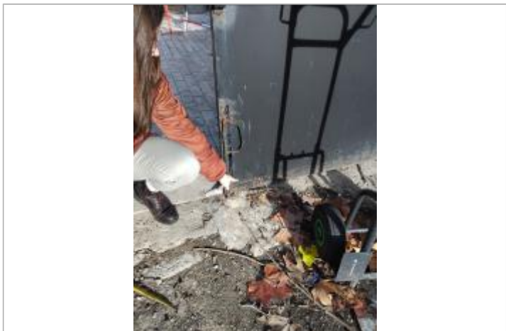
Marque d'inondation sur le bas du portail du n°37 place de la Libération
