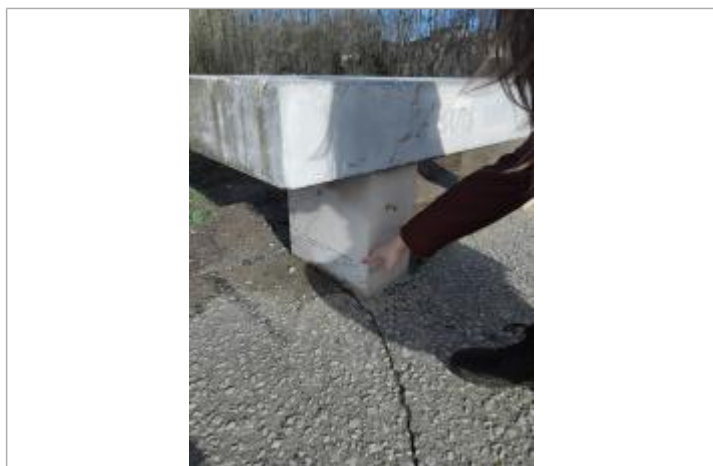
Marque d'inondation sur le pied du banc public
