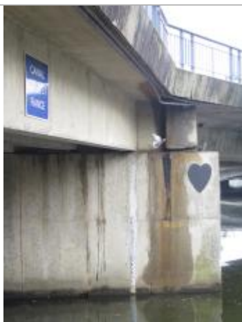
Echelle limnimétrique en aval de l'écluse du M
