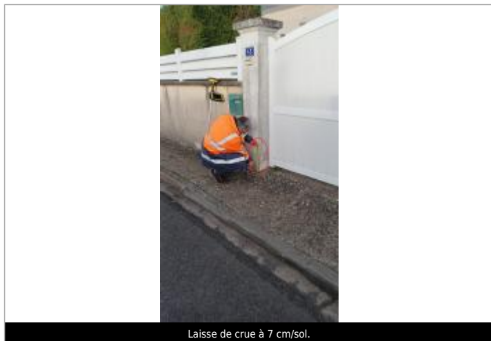
Laisse de crue à 7 cm/sol.
