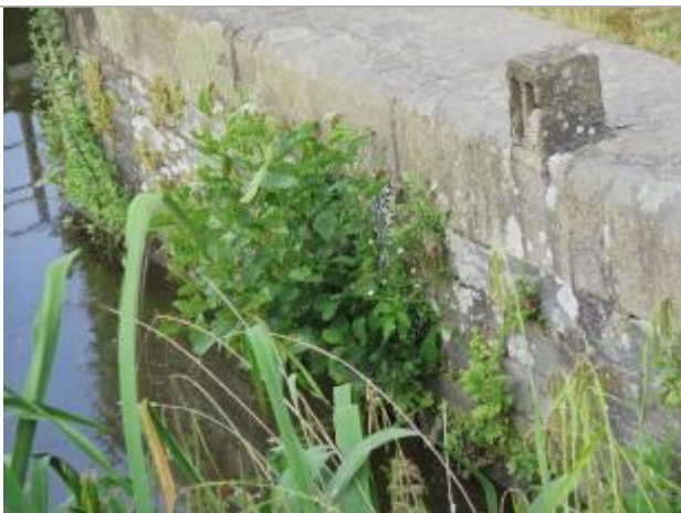
Echelle limnimétrique amont de l'écluse du Comte à Rennes
