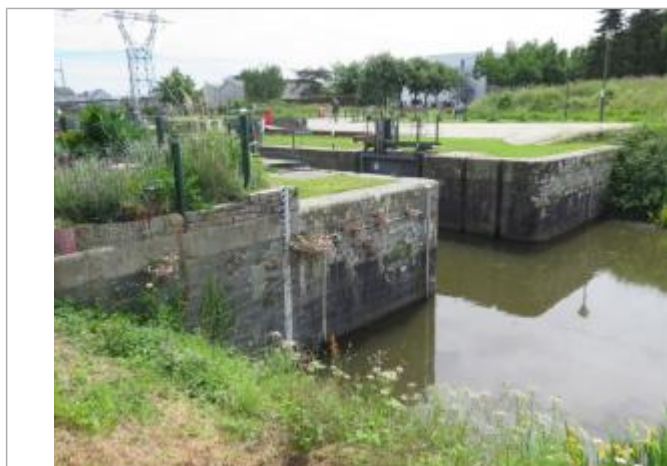
Echelle limnimétrique à l'aval de l'écluse du Comte à Rennes
