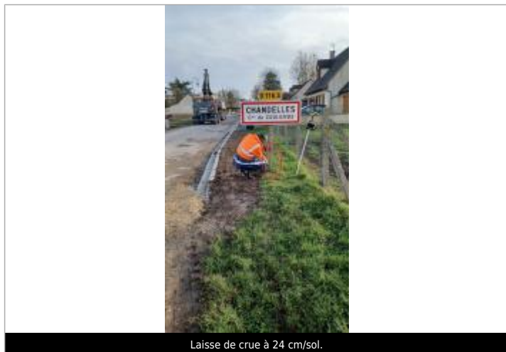
Laisse de crue à 24 cm/sol.
