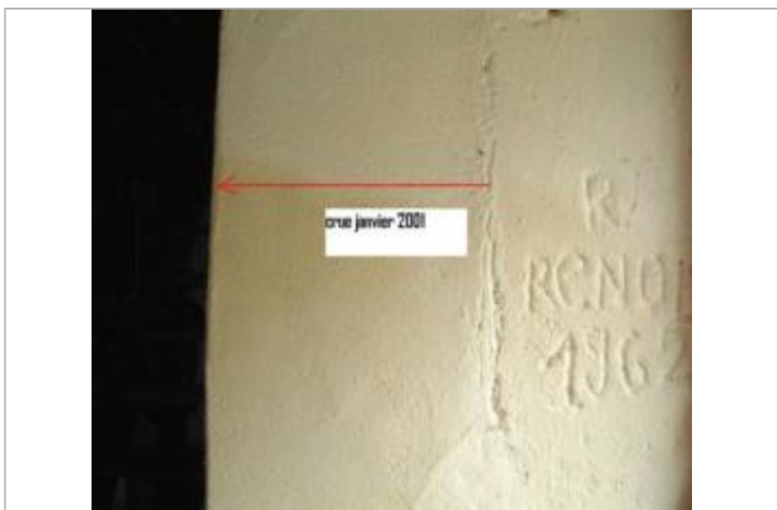
Marquage du niveau de hauteur de crue
