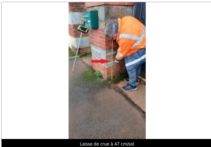
Laisse de crue à 47 cm/sol
