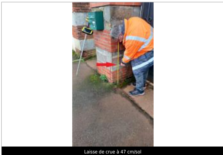
Laisse de crue à 47 cm/sol
