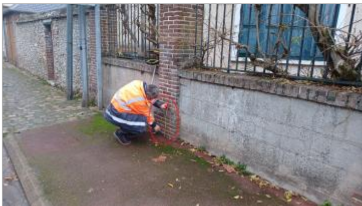
Laisse de crue à 4 cm/sol.
