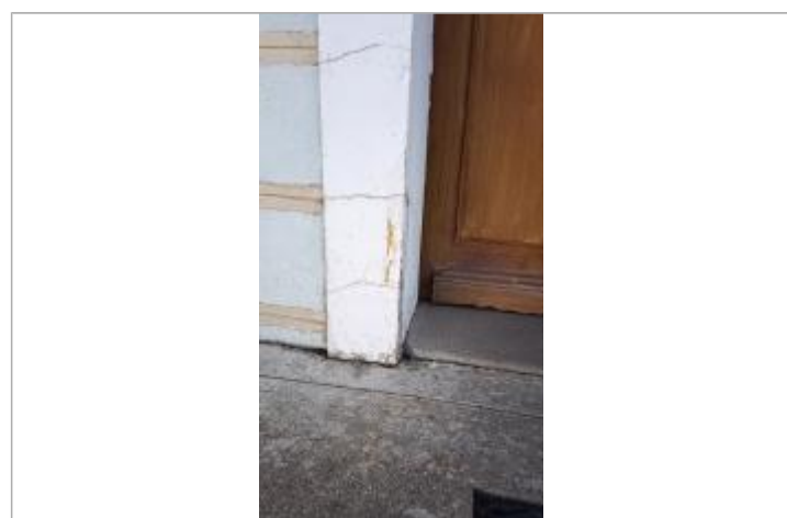
2025_Vue du repère (5 cm au dessus du seuil de la porte)
