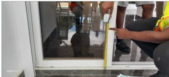
Dépôts de matières solides sur la baie vitrée
