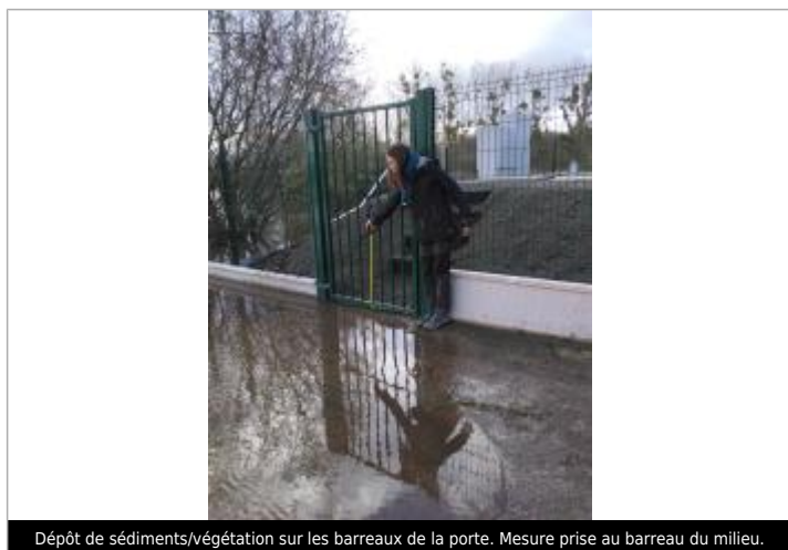
Dépôt de sédiments/végétation sur les barreaux de la porte. Mesure prise au barreau du milieu.
