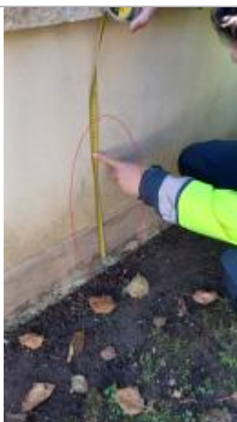
Laisse de crue à 45 cm/rebord en béton.
